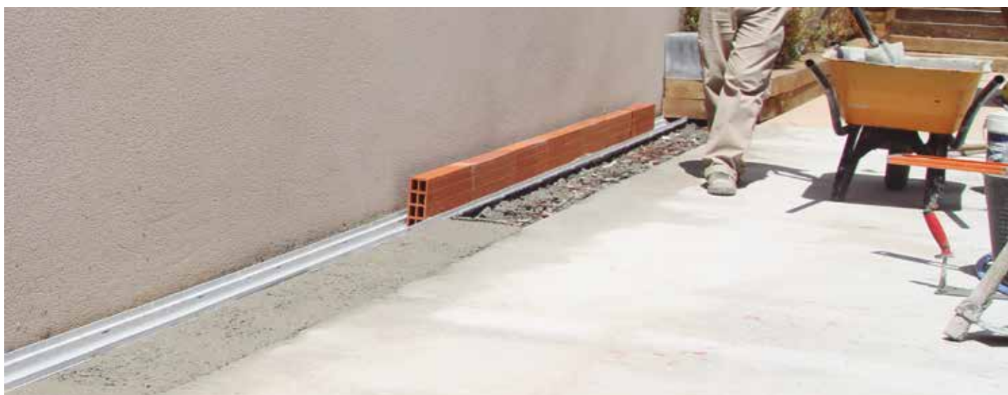
Vista de la canaleta de pvc colocada en fase de relleno de mortero
