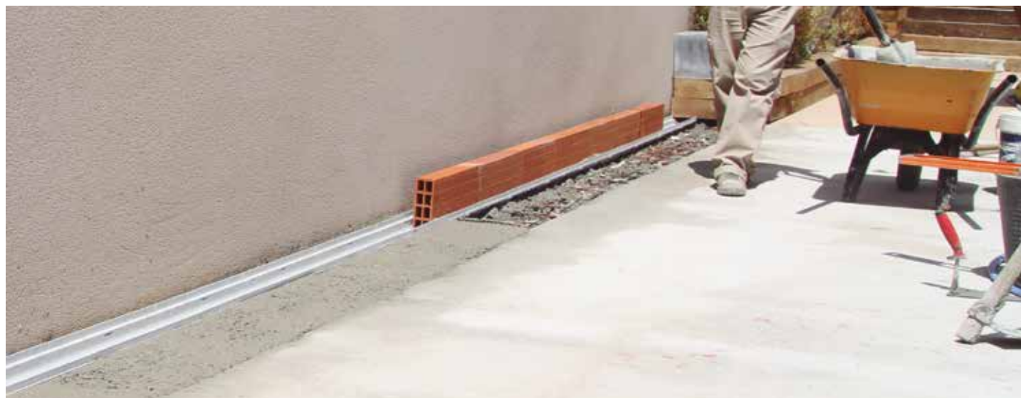
Vue de la goulotte en pvc durant la phase de remplissage de mortier
